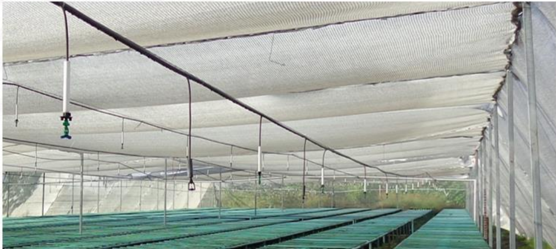
Imagen 2. Sistema de riego suspendido (aéreo) en estructura independiente.
